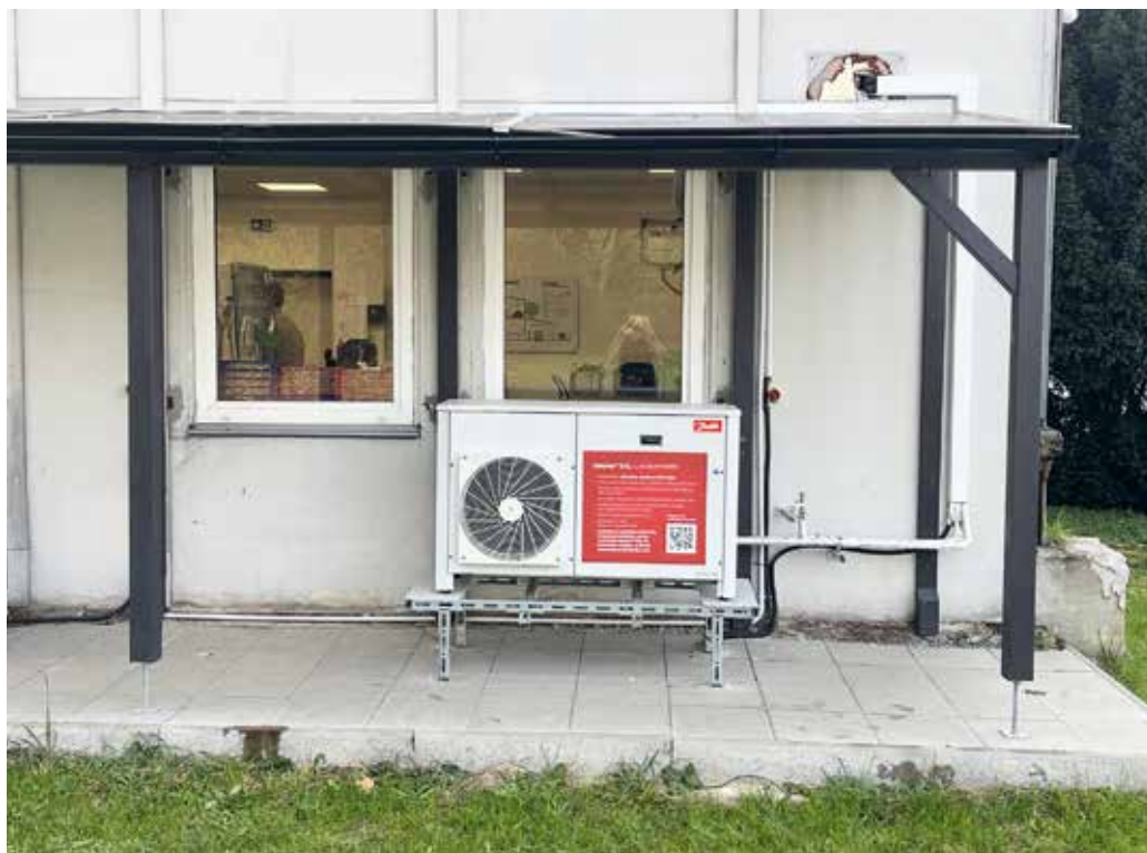
Obr. 1: Kondenzační jednotka Optyma iCO 2 je umístěná ve venkovním zastřešeném prostoru, hned za okny dílny chlazení
