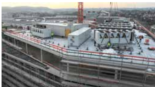
Umístění propanových jednotek na střeše objektu
