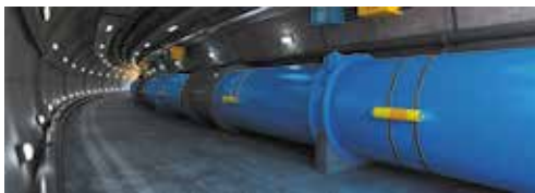
Urychlovač částic potřebuje mnoho místa, energie a chlazení
