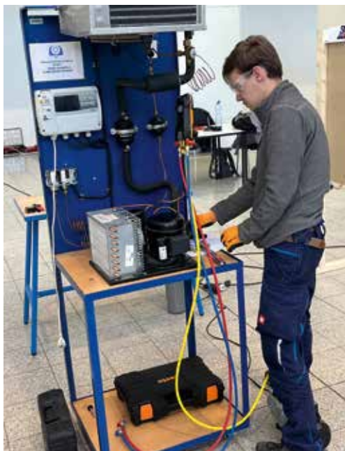
Obr. 7: měření a diagnostika parametrů chladicí jednotky. Naměřené údaje zanesli soutěžící do diagramu i log/p. Na jejich základě měli určit závadu zařízení, které bylo silně přeplněné chladivem.
