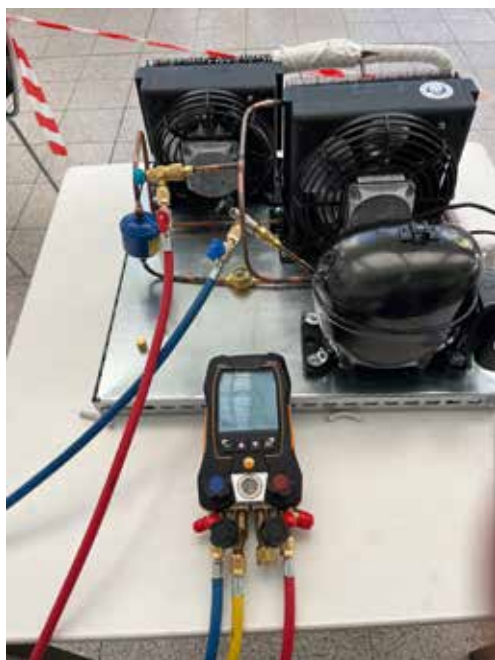
Obr. 13: diagnostické přístroje nám do soutěže zapůjčila firma TESTO
